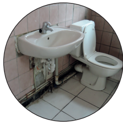
Équipement sanitaire à remettre dans le circuit
