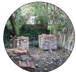
Les briques issues de la démolition sont ré-utilisées pour rehausser les allèges et ragréage de l'existant
